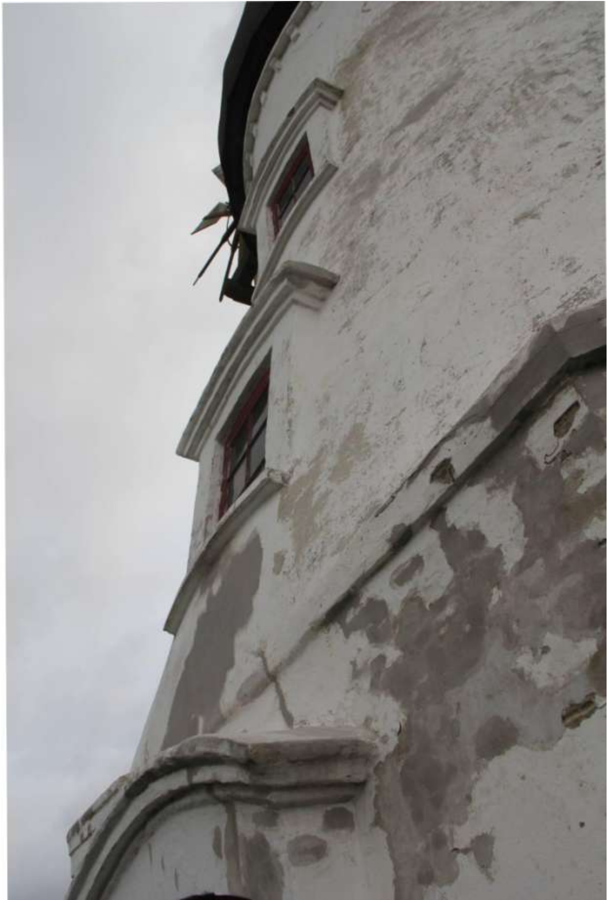
Christiansmøllen Svendborg. Foto nr. 04. Eksempel på pudsreparationer – med cementbaserede mørtler. Der kan også konstateres pudsafskalninger ved defekte facadesten.. Kalkning har også svært ved at holde på den anvendte reparationsmørtel.
