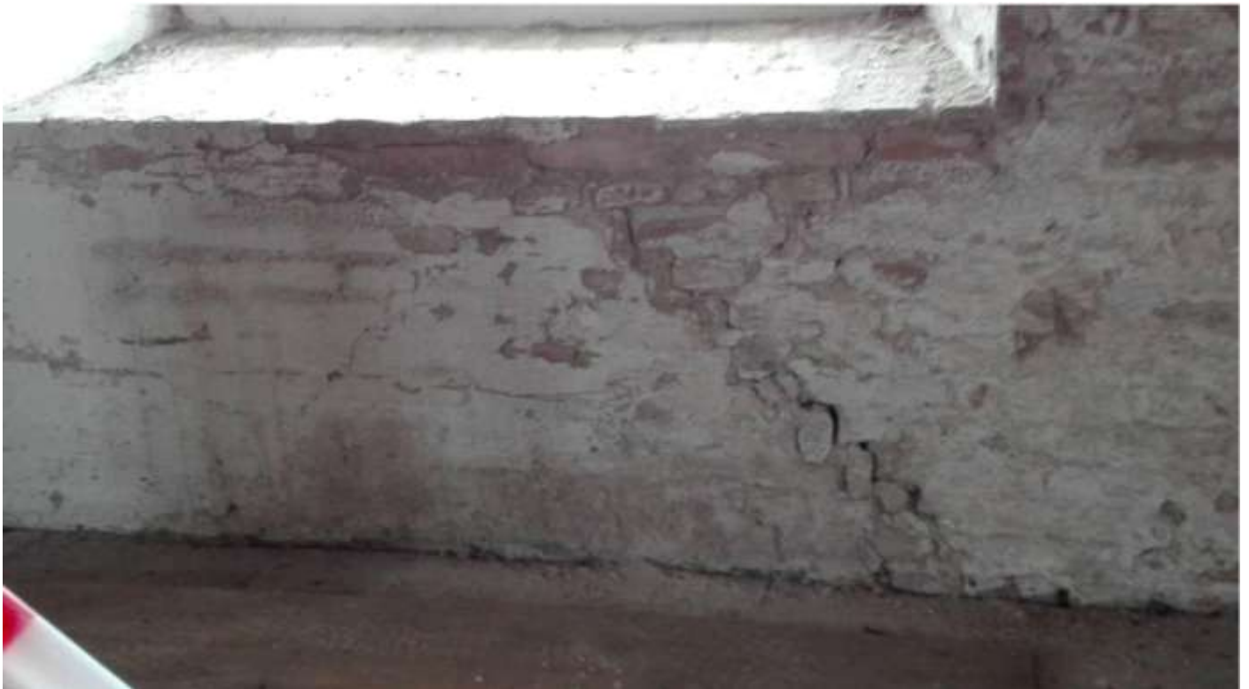
Christiansmøllen Svendborg. Foto nr. 06. Eksempel på gennemgående revnedannelser - her under vindue i "Overmøllen".
