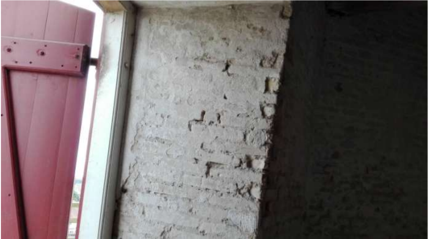
Christiansmøllen Svendborg. Foto nr. 05. Eksempel på indad hældende murværk og skrånende fuger, som kan lede vand ind i møllebygningen.
