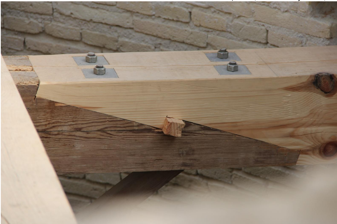
Det gamle tømmer forlænges med "fransk lås". (herunder) Som låses med to kiler – én fra hver side Flot tømmerarbejde
