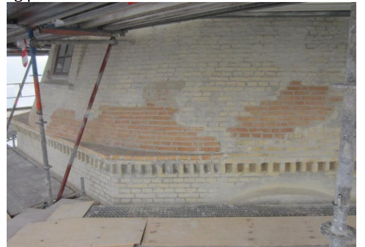
Overmøllen er muret til og nogle steder pudset
