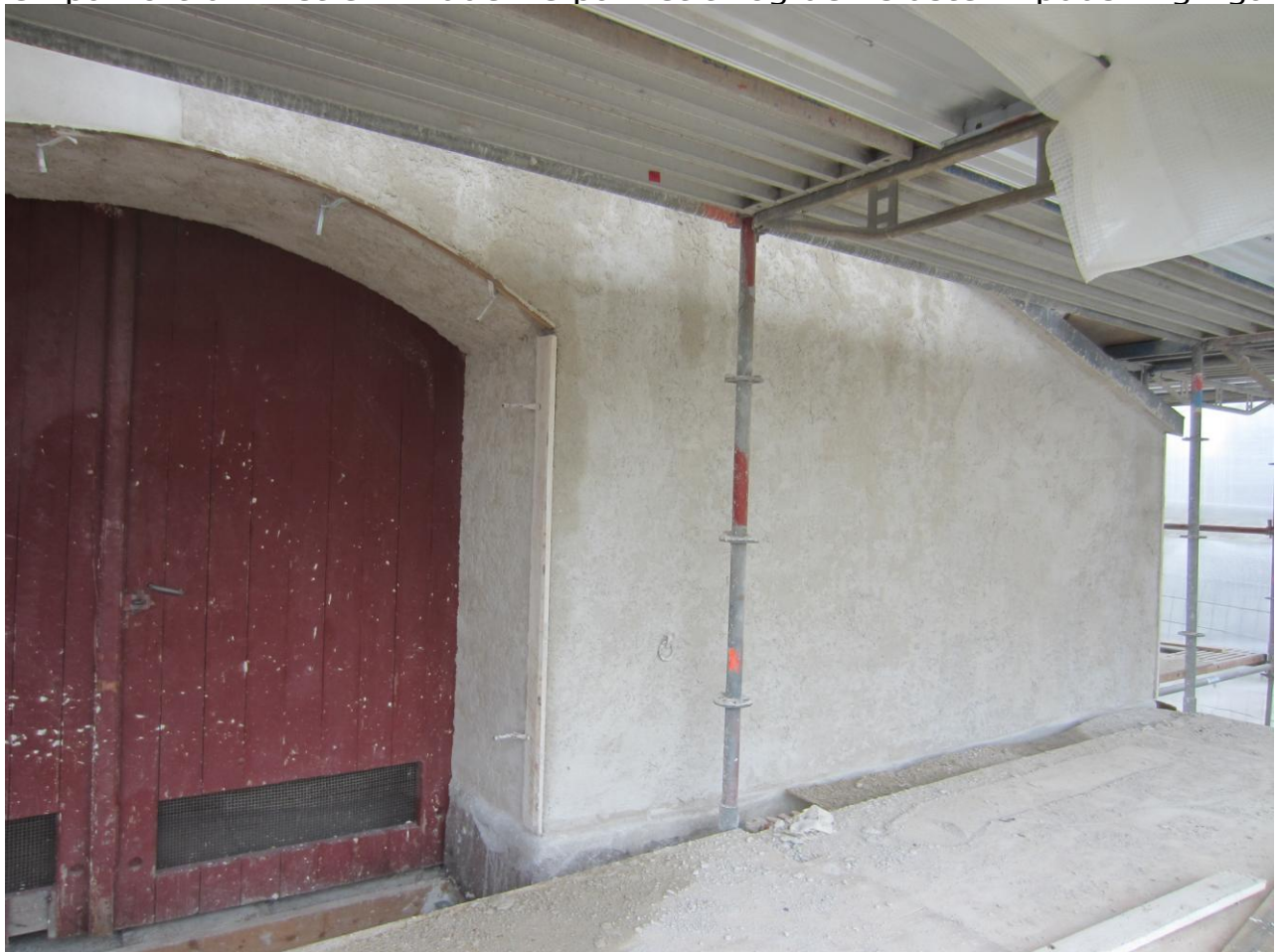
Lige over Porten kan man se skillelinjen mellem fin- og grovpudsning Ikke mange meter mangler! Som det ses lakker det hastigt mod enden med restaureringen af Christiansmøllen
