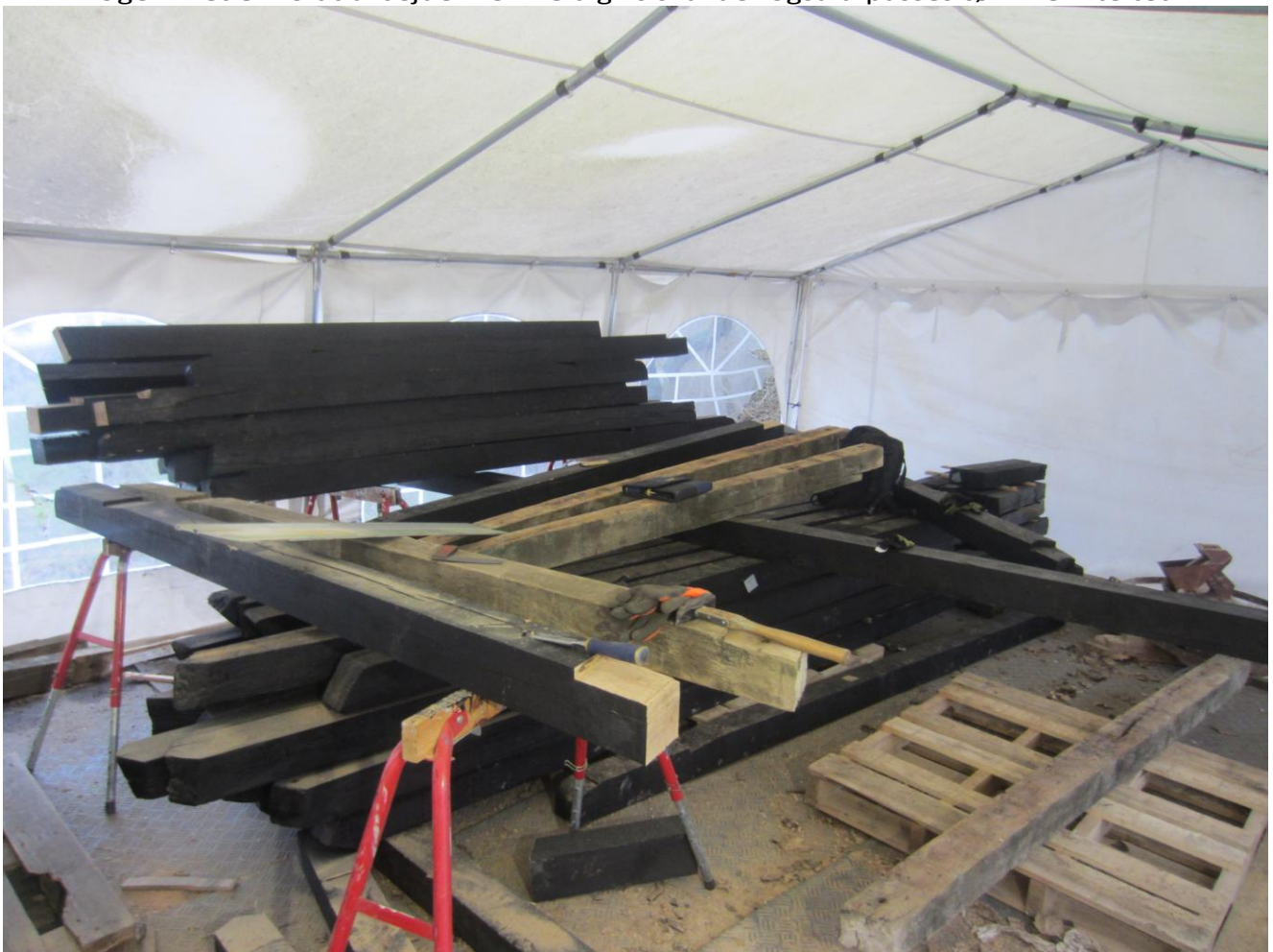
Alt træet til skelettet af Svikstillingen ligger her og tilpasses undervejs i arbejdet.
