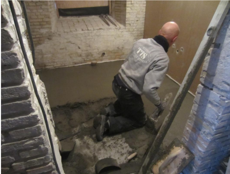
Onsdag d 17-1-2018 nåede murerne ( 3 stk) at få lavet gulvene i Toilet og køkken
