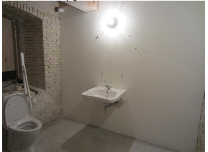
Handicapvenlige toilet ligeså
