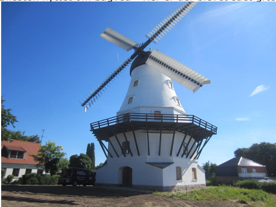
I dag torsdag mødtes folk fra laugnet, kommunen, arkitekten og et par stykker fra TTS, samt bla elektriker. Hele Byggepladsen ude og inde blev gennemgået og de sidste aftaler lavet omkring bla. vinduer.
