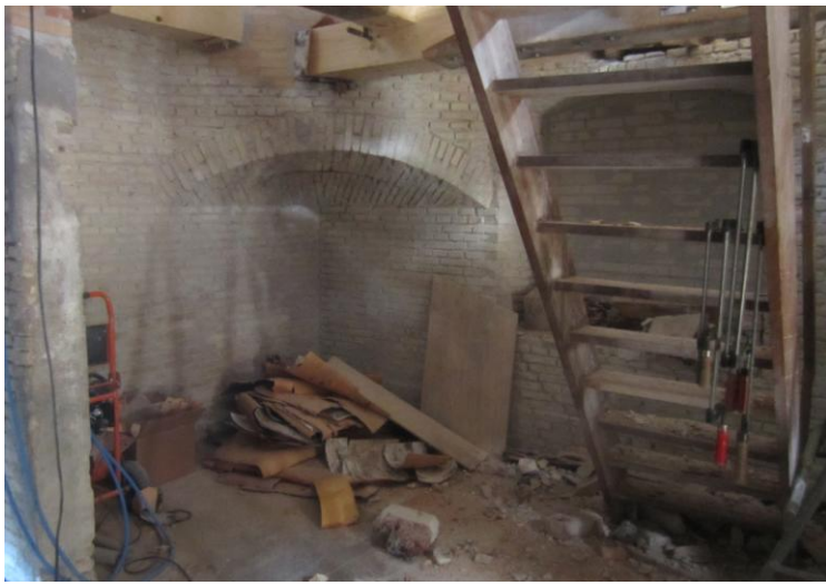
Helt nede i portrummet hvor håndværkerne også er langt med de sidste mur- og bjælkeudskiftninger
