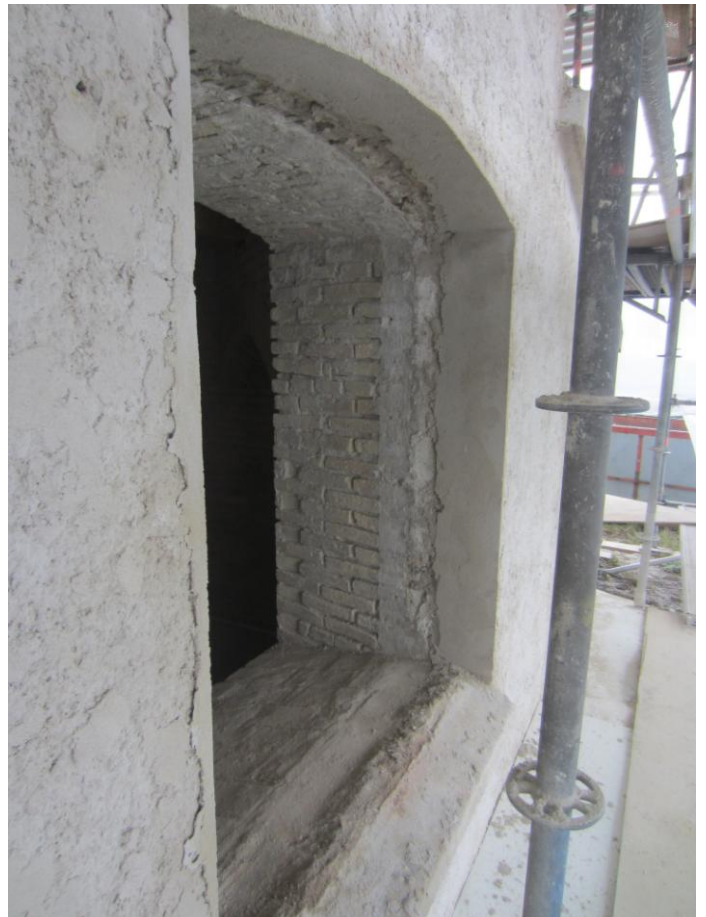
Ellers er der blevet sprøjtet grovpuds på hele undermøllen og gjort klar omkring vinduerne.
